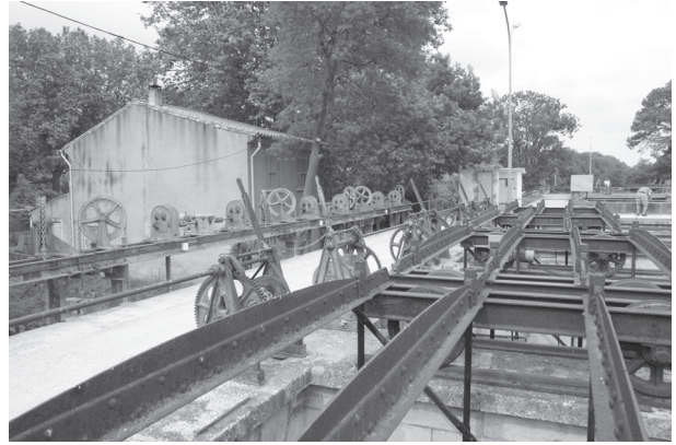
Kołowroty napędowe zastawek i wózków wrót powodziowych
